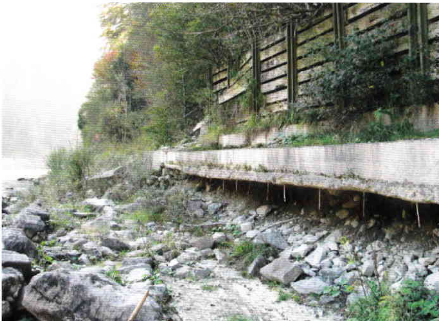
Die meist zerstörte Stelle der Strecke liegt ca. bei km 10,5 in einer Linkskurve der Bregenzerache. Hier ist die Trasse selber ca. einen Meter tief komplett abgetragen und weggespült worden.
