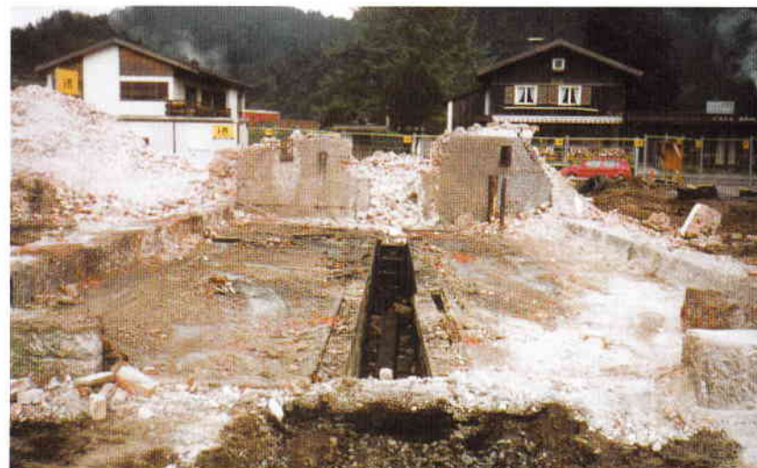
Kaum konnte der Lokschuppen als geräumt gemeldet werden, sind von unbekannten Vandalen schon alle Scheiben eingeschlagen worden. In dem Zustand ist das Gebäude in kürzester zum Schandfleck verkommen. Der Abbruch zwischen 3. und 5. Juli ist von der betroffenen Umgebung nur mehr als Beseitigung einer Ruine registriert worden. (Fotos: E. Cavegn)
