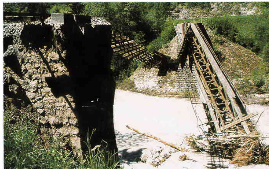
Das in die Bregenzerache gestürzte Martinflußeisentragwerk, davor ist der im Fluß liegende Pfeiler zu erkennen. (Foto: Walter Rabanser)
